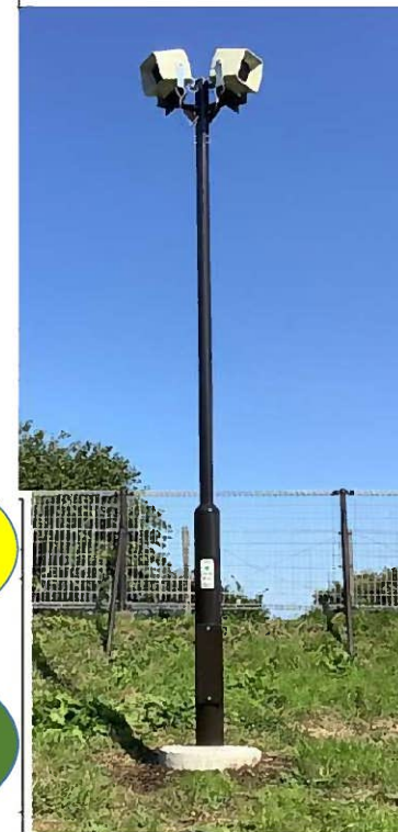
放送設備（スピーカー）
