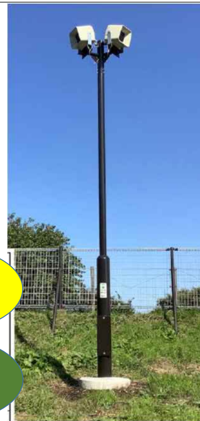
放送設備（スピーカー）
