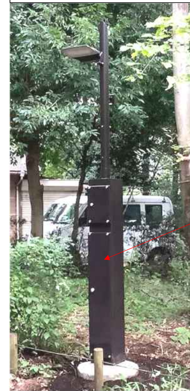
非常用照明灯
